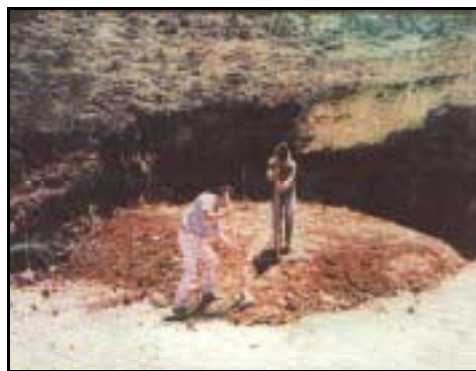
Relleno Sanitario: Tipo operación manual
